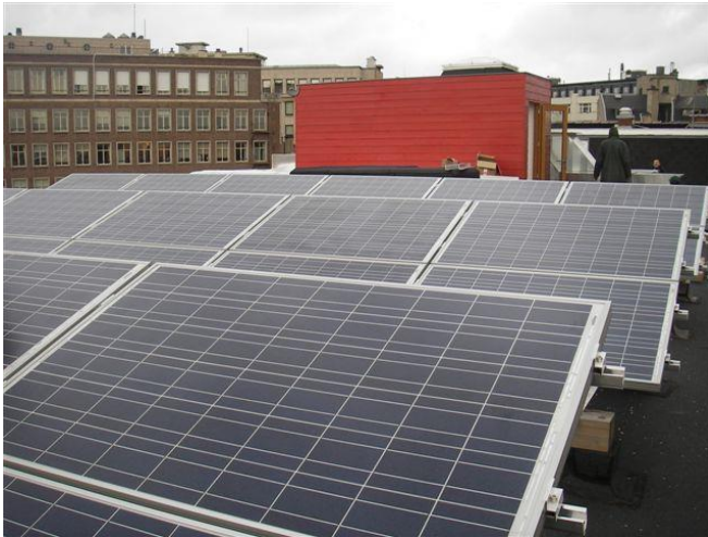
FV panelen op dak
